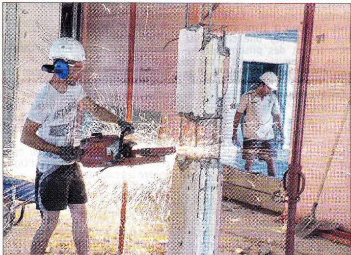
D'importants travaux de modification de la structure du bâtiment sont en cours.
